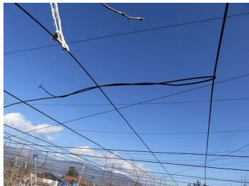
図1 断裂した引線
