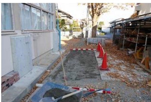
施工場所を測量し碎石を入れ、 平板を敷く準備をしています
