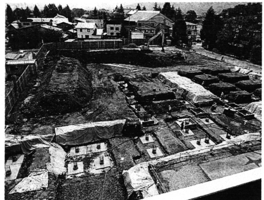
平成 26 年 8 月末スポーツ科学科棟建設現場 (管理普通教室棟 4 階東側窓より撮影)
