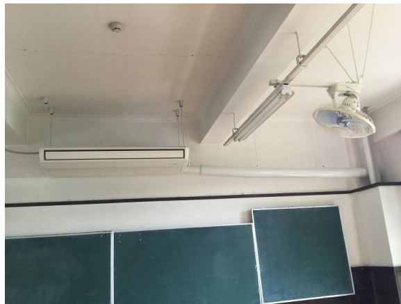
1棟の各教室にもエアコンが設置。景観に配慮が！
