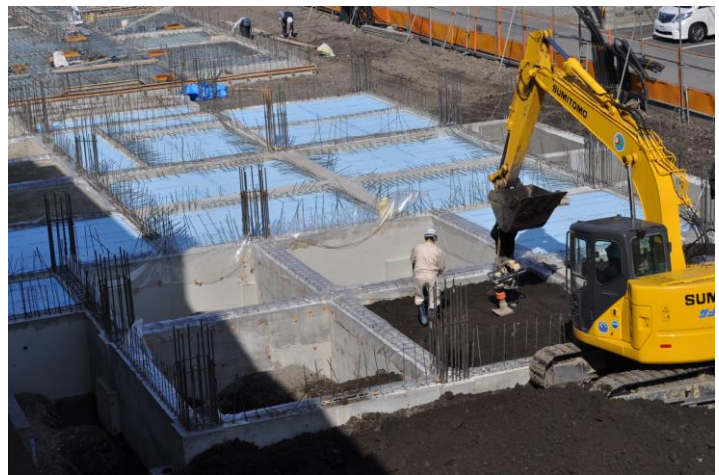
H26.4.9 現在 寄宿舍・食堂ともに一階の土間のコンクリート打設及び基礎配管工事
