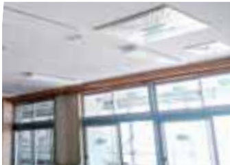
全HR教室エアコン完備
