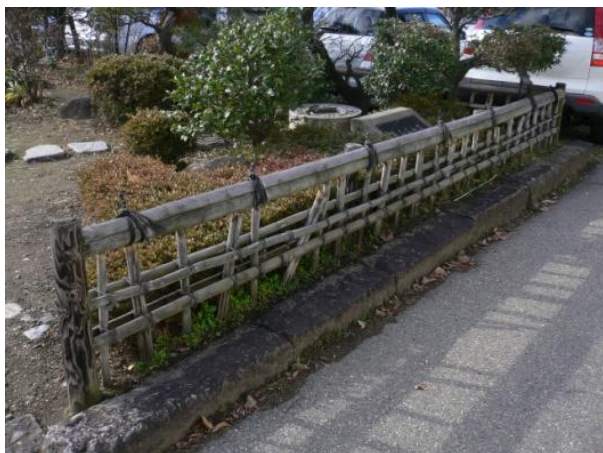
老朽化した金閣寺垣
